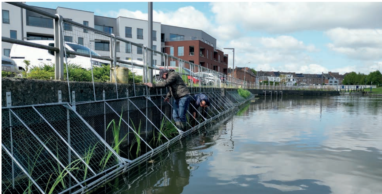
Paniers végétalisés sur le Canal Ath-Blaton à Ath
